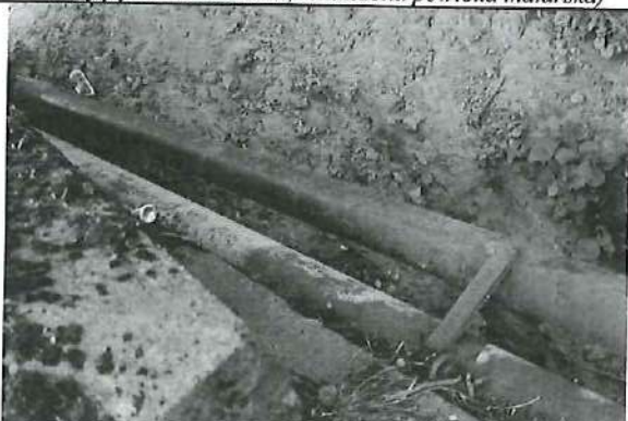
Fot. 421. Instalacje podwieszone do obiektu – po stronie wody górnej (Korozja na podwieszonych rurach osłonowych oraz uchwytych mocujących i wieszakach, złuszczone powłoka malarska)
