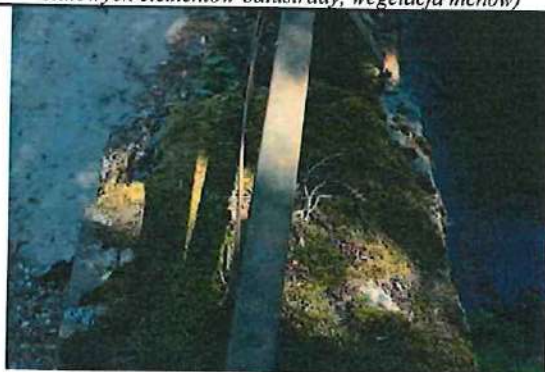
Fot. 241. Balustrada po stronie wody dolnej (Skruszony beton murka, spękania betonu, organiczny nalot, brak powłoki ochronnej betonu, korozja odsłoniętego zbrojenia oraz stalowych elementów balustrady, wegetacja mchów)
