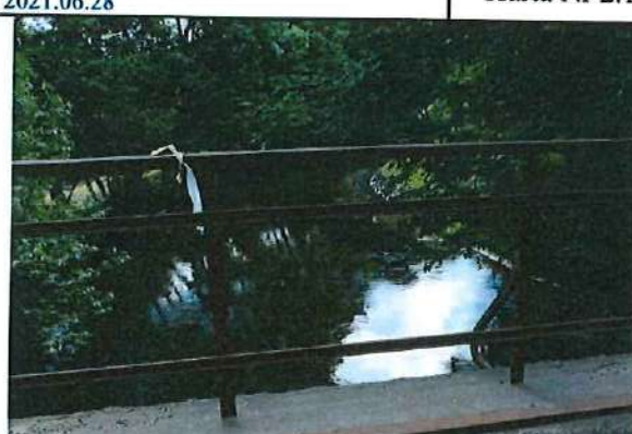
Fot. 160. Balustrada po stronie wody dolnej (Powyginane i skorodowane stalowe elementy balustrady, brak powłoki malarskiej, miejscowe wżery, organiczny nalot)
