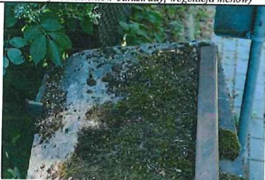
Fot. 243. Balustrada po stronie wody dolnej (Skruszony beton murka, spękania betonu, organiczny nalot, brak powłoki ochronnej betonu, korozja odsłoniętego zbrojenia oraz stalowych elementów balustrad, wegetacja mchów y)
