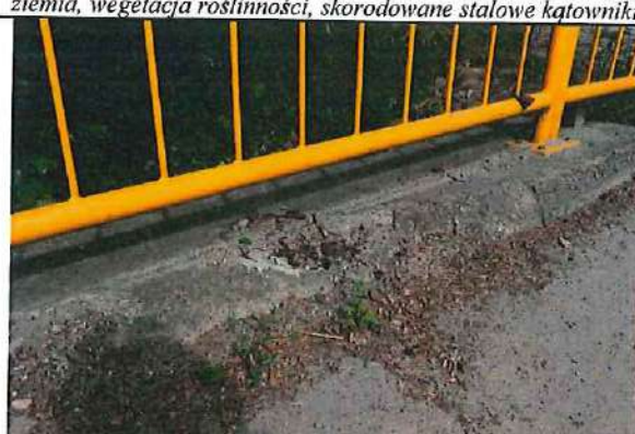
Fot. 278. Kapa i gzyms po stronie wody górnej (Spękania i wykruszenia betonu, zanieczyszczenia, zalegająca ziemia, wegetacja roślinności)
