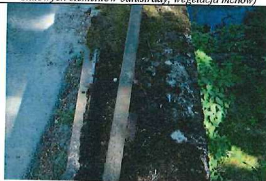
Fot. 242. Balustrada po stronie wody dolnej (Skruszony beton murka, spękania betonu, organiczny nalot, brak powłoki ochronnej betonu, korozja odsłoniętego zbrojenia oraz stalowych elementów balustrady, wegetacja mchów)
