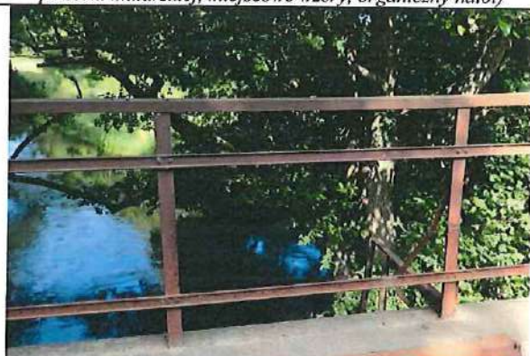
Fot. 117. Balustrada po stronie wody górnej (Powyginane i skorodowane stalowe elementy balustrady, brak powłoki malarskiej, miejscowe wżery, organiczny nalot)
