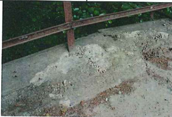
Fot. 271. Kapa i gzyms po stronie wody górnej (Spękania i wykruszenia betonu, zanieczyszczenia, zalegająca ziemia, wegetacja roślinności, skorodowane stalowe kątowniki)
