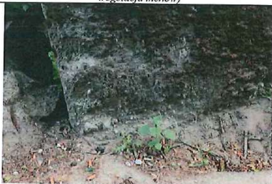
Fot. 213. Balustrada po stronie wody dolnej (Poniszczony mur oporowy, spękania, wykruszenia betonu, organiczny nalot, wegetacja mchów)
