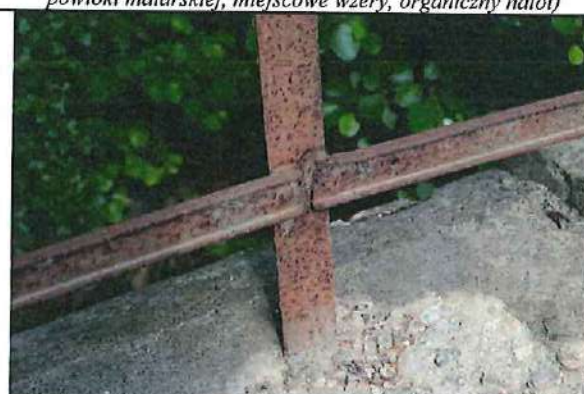
Fot. 148. Balustrada po stronie wody górnej (Powyginane i skorodowane stalowe elementy balustrady, brak powłoki malarskiej, miejscowe wżery, organiczny nalot)
