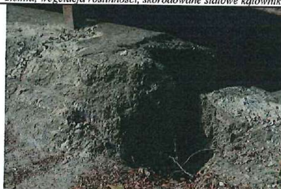
Fot. 274. Kapa i gzyms po stronie wody górnej (Miejsce załamania konstrukcji, wykruszenia i ubytki betonu, zalegający piasek oraz ziemia, brak powłoki ochronnej)
