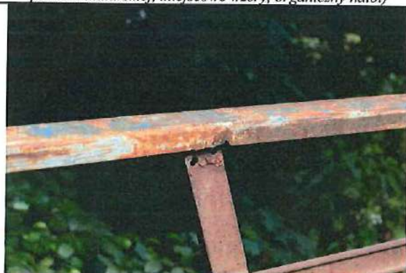
Fot. 149. Balustrada po stronie wody górnej (Powyginane i skorodowane stalowe elementy balustrady, brak powłoki malarskiej, miejscowe wżery, organiczny nalot)
