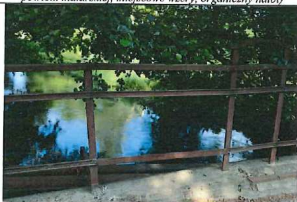
Fot. 113. Balustrada po stronie wody górnej (Powyginane i skorodowane stalowe elementy balustrady, brak powłoki malarskiej, miejscowe wżery, organiczny nalot)
