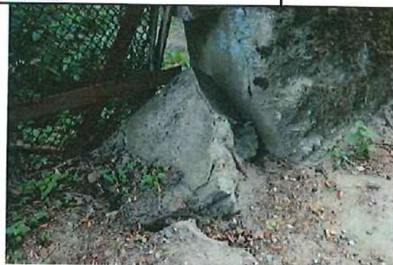
Fot. 208. Balustrada po stronie wody dolnej (Poniszczony mur oporowy, spękania, wykruszenia betonu, organiczny nalot, skorodowane stalowe elementy balustrady, wegetacja mchów)
