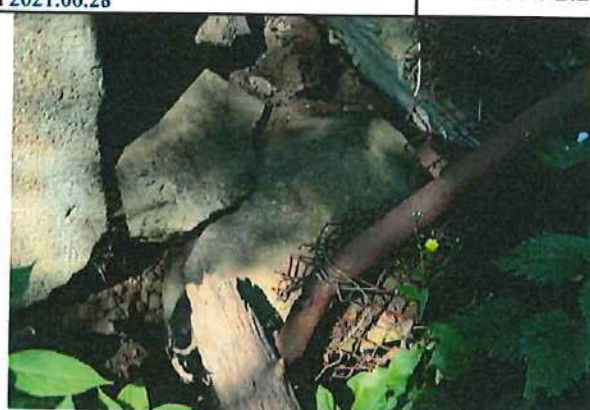
Fot. 256. Balustrada po stronie wody dolnej (Polamane i porozrzucane betonowe bloki murka oporowego)
