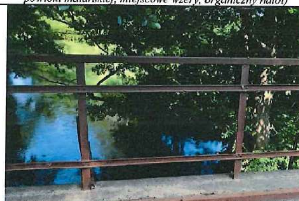
Fot. 116. Balustrada po stronie wody górnej (Powyginane i skorodowane stalowe elementy balustrady, brak powłoki malarskiej, miejscowe wżery, organiczny nalot)
