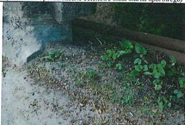
Fot. 257. Kapa i gzyms po stronie wody górnej (Spękania i wykruszenia betonu, zanieczyszczenia, zalegająca ziemia, wegetacja roślinności, skorodowane stalowe kątowniki)
