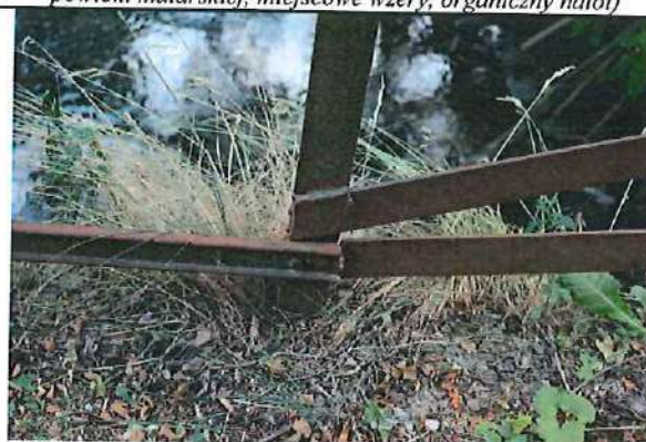
Fot. 198. Balustrada po stronie wody dolnej (Powyginane i skorodowane stalowe elementy balustrady, brak powłoki malarskiej, miejscowe wżery, organiczny nalot)
