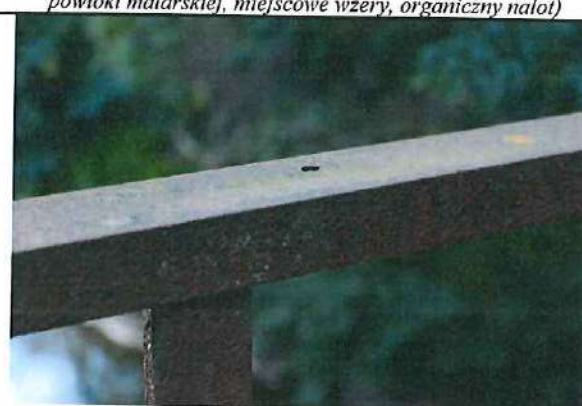
Fot. 182. Balustrada po stronie wody dolnej (Powyginane i skorodowane stalowe elementy balustrady, brak powłoki malarskiej, miejscowe wżery, organiczny nalot)
