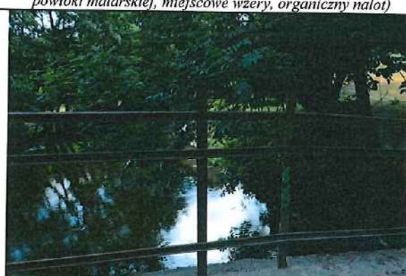
Fot. 162. Balustrada po stronie wody dolnej (Powyginane i skorodowane stalowe elementy balustrady, brak powłoki malarskiej, miejscowe wżery, organiczny nalot)
