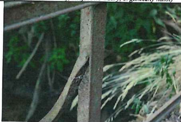
Fot. 193. Balustrada po stronie wody dolnej (Powyginane i skorodowane stalowe elementy balustrady, brak powłoki malarskiej, miejscowe wżery, organiczny nalot)
