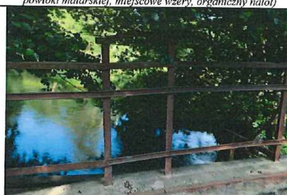
Fot. 114. Balustrada po stronie wody górnej (Powyginane i skorodowane stalowe elementy balustrady, brak powłoki malarskiej, miejscowe wżery, organiczny nalot)
