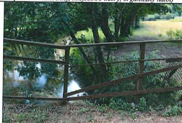
Fot. 165. Balustrada po stronie wody dolnej (Powyginane i skorodowane stalowe elementy balustrady, brak powłoki malarskiej, miejscowe wżery, organiczny nalot)
