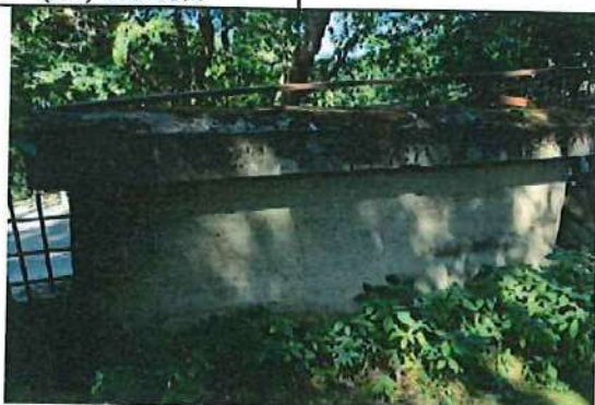
Fot. 239. Balustrada po stronie wody dolnej (Skruszony beton murka, spękania betonu, organiczny nalot, brak powłoki ochronnej betonu, korozja odsłoniętego zbrojenia oraz stalowych elementów balustrady, wegetacja mchów)
