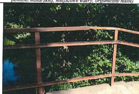
Fot. 118. Balustrada po stronie wody górnej (Powyginane i skorodowane stalowe elementy balustrady, brak powłoki malarskiej, miejscowe wżery, organiczny nalot)
