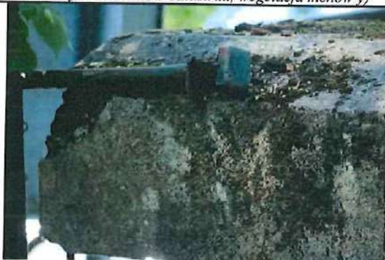
Fot. 245. Balustrada po stronie wody dolnej (Skruszony beton murka, spękania betonu, organiczny nalot, brak powłoki ochronnej betonu, korozja odsłoniętego zbrojenia oraz stalowych elementów balustrad, wegetacja mchów y)
