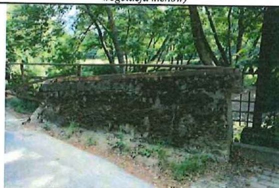
Fot. 210. Balustrada po stronie wody dolnej (Poniszczony mur oporowy, spękania, wykruszenia betonu, organiczny nalot, skorodowane stalowe elementy balustrady, wegetacja mchów)
