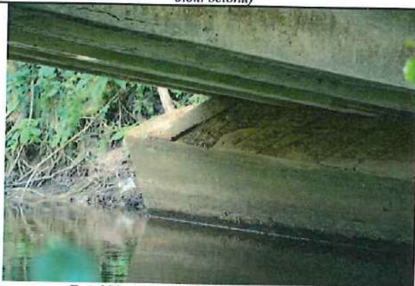
Fot. 323. Przyczółek po stronie drogi DK-6 (Zarwany i uszkodzony przyczółek)
