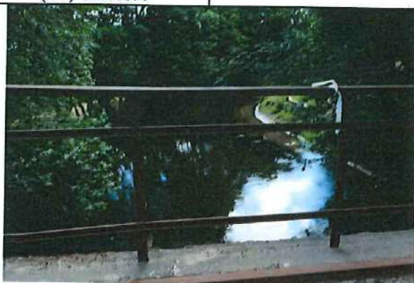
Fot. 159. Balustrada po stronie wody dolnej (Powyginane i skorodowane stalowe elementy balustrady, brak powłoki malarskiej, miejscowe wżery, organiczny nalot)
