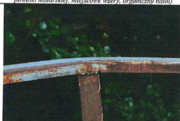
Fot. 146. Balustrada po stronie wody górnej (Powyginane i skorodowane stalowe elementy balustrady, brak powłoki malarskiej, miejscowe wżery, organiczny nalot)
