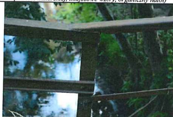
Fot. 196. Balustrada po stronie wody dolnej (Powyginane i skorodowane stalowe elementy balustrady, brak powłoki malarskiej, miejscowe wżery, organiczny nalot)
