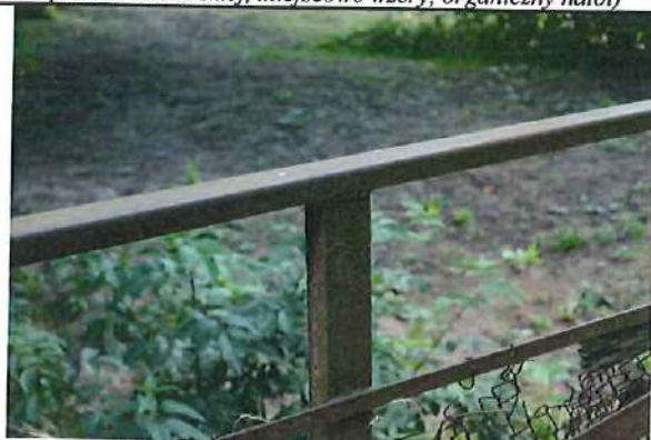
Fot. 197. Balustrada po stronie wody dolnej (Powyginane i skorodowane stalowe elementy balustrady, brak powłoki malarskiej, miejscowe wżery, organiczny nalot)
