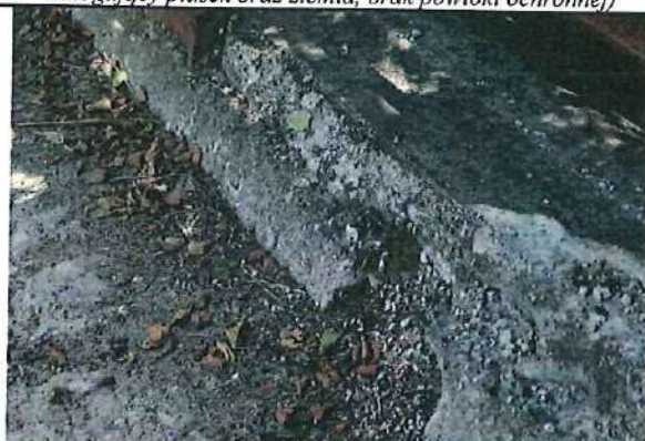
Fot. 275. Kapa i gzyms po stronie wody górnej (Spękania i wykruszenia betonu, zanieczyszczenia, zalegająca ziemia, wegetacja roślinności, skorodowane stalowe kątowniki)
