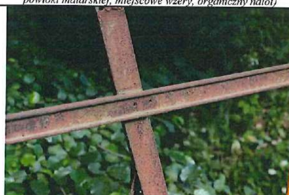
Fot. 150. Balustrada po stronie wody górnej (Powyginane i skorodowane stalowe elementy balustrady, brak powłoki malarskiej, miejscowe wżery, organiczny nalot)
