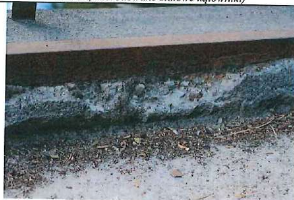
Fot. 294. Kapa i gzyms po stronie wody dolnej (Spękania i wykruszenia betonu, zanieczyszczenia, zalegająca ziemia, skorodowane stalowe kątowniki)
