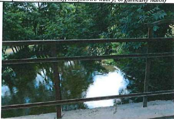
Fot. 161. Balustrada po stronie wody dolnej (Powyginane i skorodowane stalowe elementy balustrady, brak powłoki malarskiej, miejscowe wżery, organiczny nalot)
