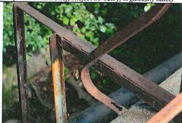
Fot. 145. Balustrada po stronie wody górnej (Powyginane i skorodowane stalowe elementy balustrady, brak powłoki malarskiej, miejscowe wżery, organiczny nalot)
