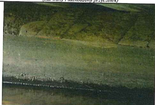
Fot. 326. Przyczółek po stronie drogi DK-6 (Zarwany i uszkodzony przyczółek, obsunięte w koryto rzeki połamane bloki betonu)
