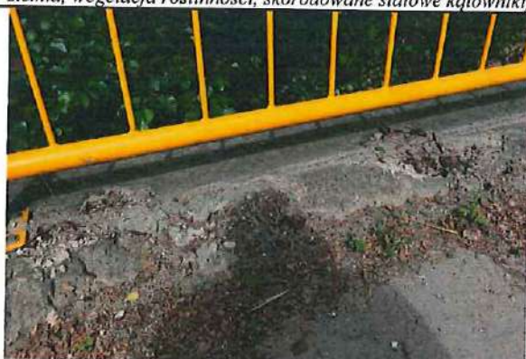
Fot. 277. Kapa i gzyms po stronie wody górnej (Spękania i wykruszenia betonu, zanieczyszczenia, zalegająca ziemia, wegetacja roślinności)
