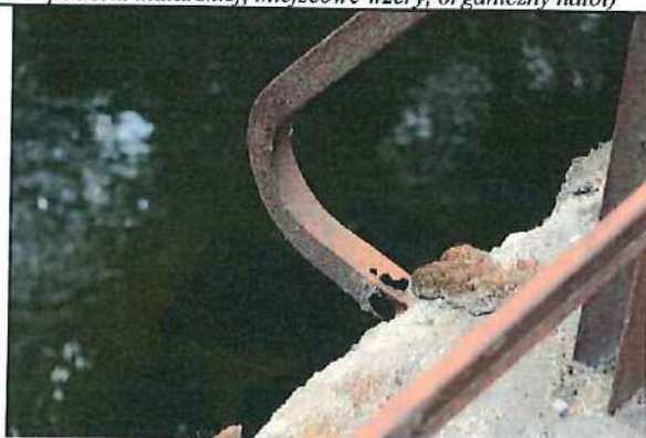
Fot. 177. Balustrada po stronie wody dolnej (Powyginane i skorodowane stalowe elementy balustrady, brak powłoki malarskiej, miejscowe wżery, organiczny nalot)
