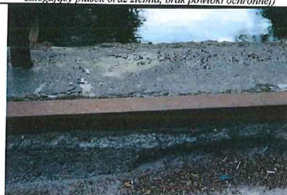
Fot. 292. Kapa i gzyms po stronie wody dolnej (Spękania i wykruszenia betonu, zanieczyszczenia, zalegająca ziemia, skorodowane stalowe kątowniki)
