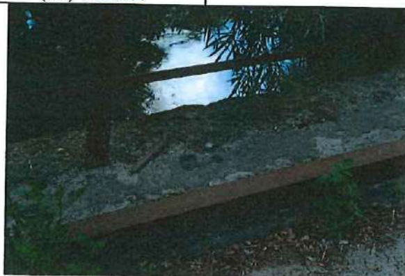
Fot. 287. Kapa i gzyms po stronie wody dolnej (Spękania i wykruszenia betonu, zanieczyszczenia, zalegająca ziemia, wegetacja roślinności, skorodowane stalowe kątowniki)
