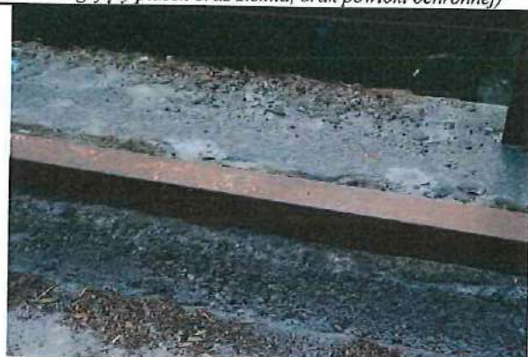
Fot. 291. Kapa i gzyms po stronie wody dolnej (Spękania i wykruszenia betonu, zanieczyszczenia, zalegająca ziemia, skorodowane stalowe kątowniki)
