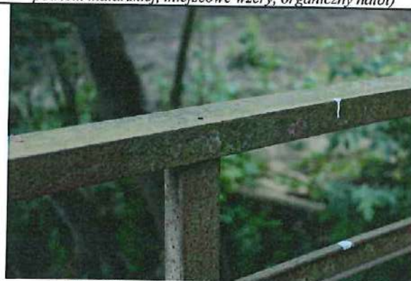
Fot. 194. Balustrada po stronie wody dolnej (Powyginane i skorodowane stalowe elementy balustrady, brak powłoki malarskiej, miejscowe wżery, organiczny nalot)
