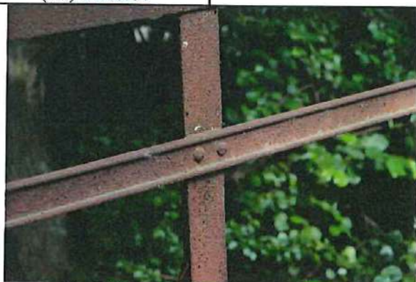
Fot. 143. Balustrada po stronie wody górnej (Powyginane i skorodowane stalowe elementy balustrady, brak powłoki malarskiej, miejscowe wżery, organiczny nalot)
