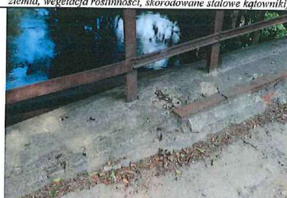
Fot. 262. Kapa i gzyms po stronie wody górnej (Spękania i wykruszenia betonu, zanieczyszczenia, zalegająca ziemia, wegetacja roślinności, skorodowane stalowe kątowniki)
