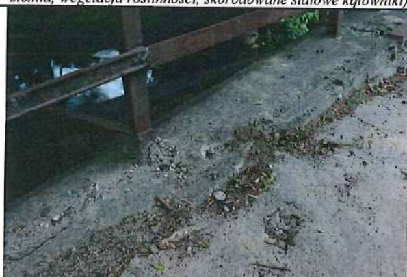
Fot. 261. Kapa i gzyms po stronie wody górnej (Spękania i wykruszenia betonu, zanieczyszczenia, zalegająca ziemia, wegetacja roślinności, skorodowane stalowe kątowniki)
