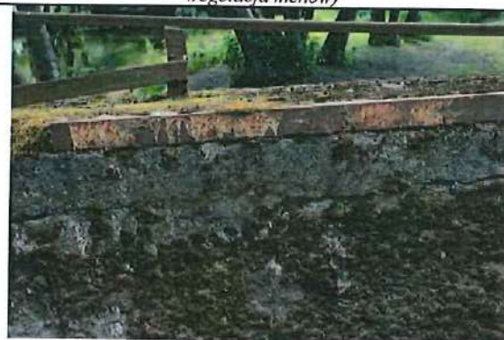
Fot. 212. Balustrada po stronie wody dolnej (Poniszczony mur oporowy, spękania, wykruszenia betonu, organiczny nalot, skorodowane stalowe elementy balustrady, wegetacja mchów)
