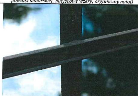
Fot. 178. Balustrada po stronie wody dolnej (Powyginane i skorodowane stalowe elementy balustrady, brak powłoki malarskiej, miejscowe wżery, organiczny nalot)
