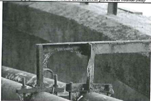
Fot. 419. Instalacje podwieszone do obiektu – po stronie wody górnej (Korozja na podwieszonych rurach osłonowych oraz uchwytych mocujących i wieszakach, złuszczone powłoka malarska)
