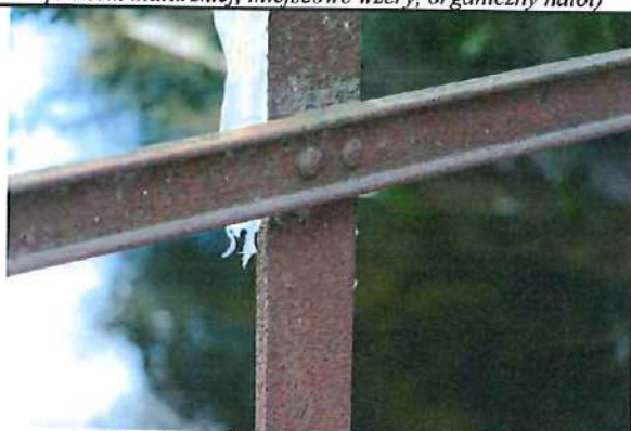
Fot. 179. Balustrada po stronie wody dolnej (Powyginane i skorodowane stalowe elementy balustrady, brak powłoki malarskiej, miejscowe wżery, organiczny nalot)
