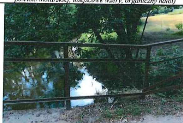
Fot. 164. Balustrada po stronie wody dolnej (Powyginane i skorodowane stalowe elementy balustrady, brak powłoki malarskiej, miejscowe wżery, organiczny nalot)
