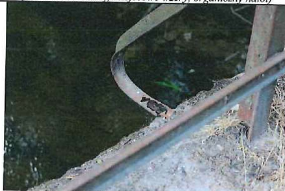
Fot. 195. Balustrada po stronie wody dolnej (Powyginane i skorodowane stalowe elementy balustrady, brak powłoki malarskiej, miejscowe wżery, organiczny nalot)
