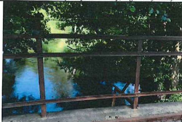
Fot. 115. Balustrada po stronie wody górnej (Powyginane i skorodowane stalowe elementy balustrady, brak powłoki malarskiej, miejscowe wżery, organiczny nalot)
