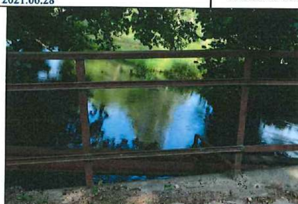
Fot. 112. Balustrada po stronie wody górnej (Powyginane i skorodowane stalowe elementy balustrady, brak powłoki malarskiej, miejscowe wżery, organiczny nalot)
