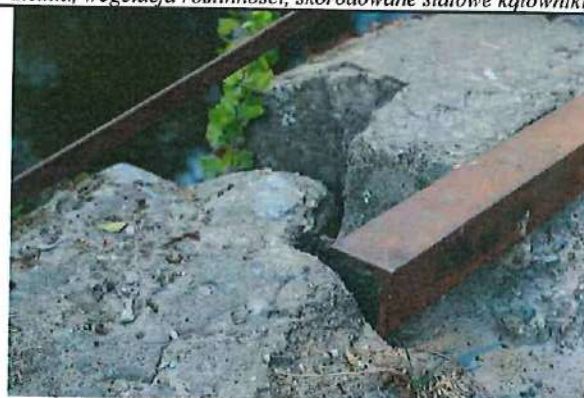
Fot. 290. Kapa i gzyms po stronie wody dolnej (Miejsce załamania konstrukcji, wykruszenia i ubytki betonu, zalegający piasek oraz ziemia, brak powłoki ochronnej)
