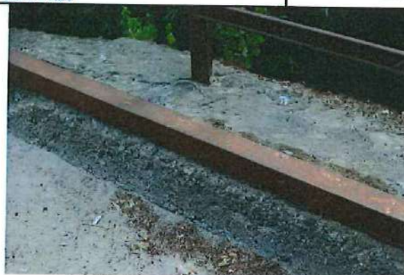
Fot. 288. Kapa i gzyms po stronie wody dolnej (Spękania i wykruszenia betonu, zanieczyszczenia, zalegająca ziemia, wegetacja roślinności, skorodowane stalowe kątowniki)
