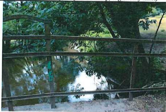
Fot. 163. Balustrada po stronie wody dolnej (Powyginane i skorodowane stalowe elementy balustrady, brak powłoki malarskiej, miejscowe wżery, organiczny nalot)
