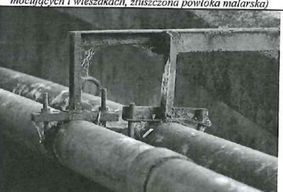
Fot. 420. Instalacje podwieszone do obiektu – po stronie wody górnej (Korozja na podwieszonych rurach osłonowych oraz uchwytych mocujących i wieszakach, złuszczone powłoka malarska)
