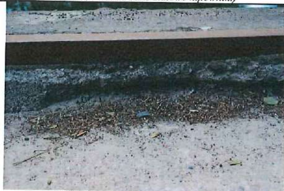
Fot. 293. Kapa i gzyms po stronie wody dolnej (Spękania i wykruszenia betonu, zanieczyszczenia, zalegająca ziemia, skorodowane stalowe kątowniki)
