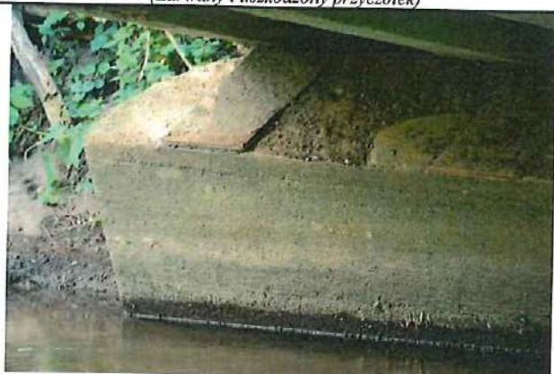
Fot. 325. Przyczółek po stronie drogi DK-6 (Zarwany i uszkodzony przyczółek, obsunięte w koryto rzeki połamane bloki betonu)
