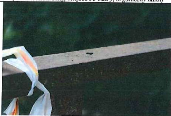
Fot. 181. Balustrada po stronie wody dolnej (Powyginane i skorodowane stalowe elementy balustrady, brak powłoki malarskiej, miejscowe wżery, organiczny nalot)
