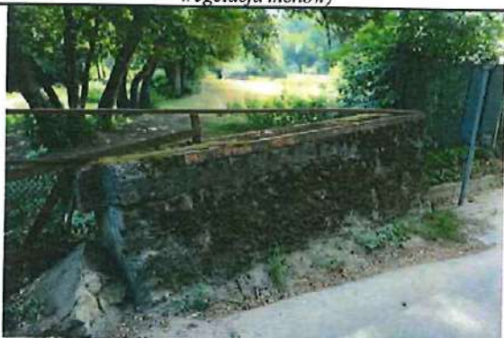
Fot. 209. Balustrada po stronie wody dolnej (Poniszczony mur oporowy, spękania, wykruszenia betonu, organiczny nalot, skorodowane stalowe elementy balustrady, wegetacja mchów)
