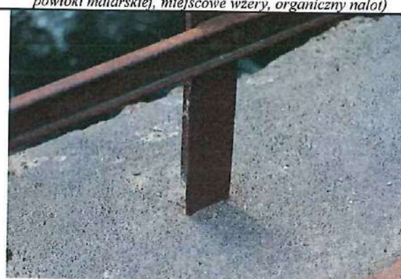
Fot. 180. Balustrada po stronie wody dolnej (Powyginane i skorodowane stalowe elementy balustrady, brak powłoki malarskiej, miejscowe wżery, organiczny nalot)
