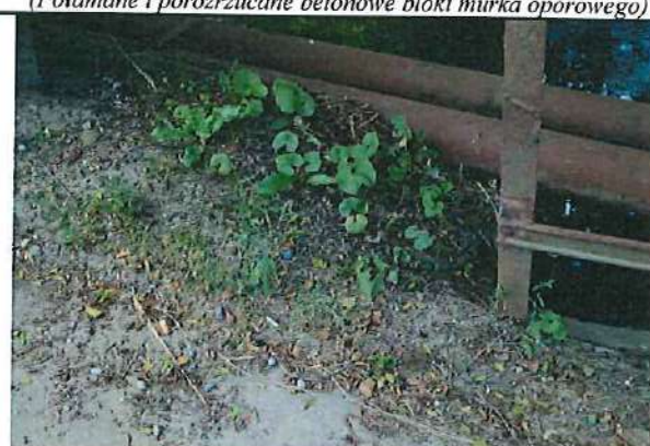
Fot. 258. Kapa i gzyms po stronie wody górnej (Spękania i wykruszenia betonu, zanieczyszczenia, zalegająca ziemia, wegetacja roślinności, skorodowane stalowe kątowniki)
