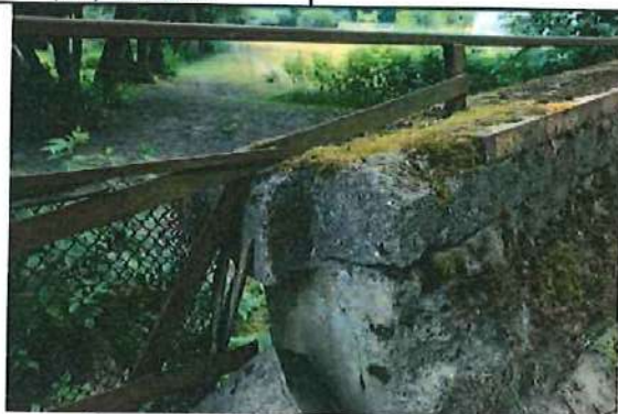
Fot. 207. Balustrada po stronie wody dolnej (Poniszczony mur oporowy, spękania, wykruszenia betonu, organiczny nalot, skorodowane stalowe elementy balustrady, wegetacja mchów)
