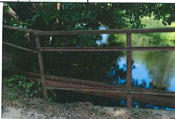
Fot. 111. Balustrada po stronie wody górnej (Powyginane i skorodowane stalowe elementy balustrady, brak powłoki malarskiej, miejscowe wżery, organiczny nalot)
