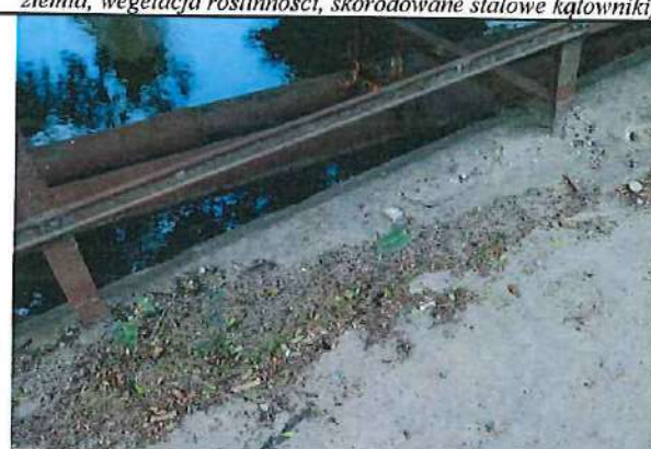
Fot. 260. Kapa i gzyms po stronie wody górnej (Spękania i wykruszenia betonu, zanieczyszczenia, zalegająca ziemia, wegetacja roślinności, skorodowane stalowe kątowniki)
