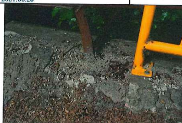
Fot. 272. Kapa i gzyms po stronie wody górnej (Spękania i wykruszenia betonu, zanieczyszczenia, zalegająca ziemia, wegetacja roślinności, skorodowane stalowe kątowniki)
