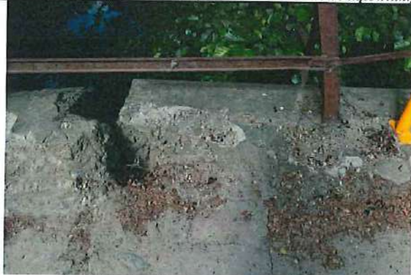
Fot. 273. Kapa i gzyms po stronie wody górnej (Miejsce załamania konstrukcji, wykruszenia i ubytki betonu, zalegający piasek oraz ziemia, brak powłoki ochronnej)
