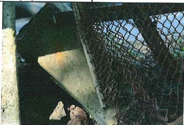
Fot. 255. Balustrada po stronie wody dolnej (Polamane i porozrzucane betonowe bloki murka oporowego)
