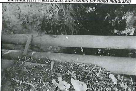
Fot. 422. Instalacje podwieszone do obiektu – po stronie wody górnej (Korozja na podwieszonych rurach osłonowych oraz uchwytych mocujących i wieszakach, złuszczone powłoka malarska)
