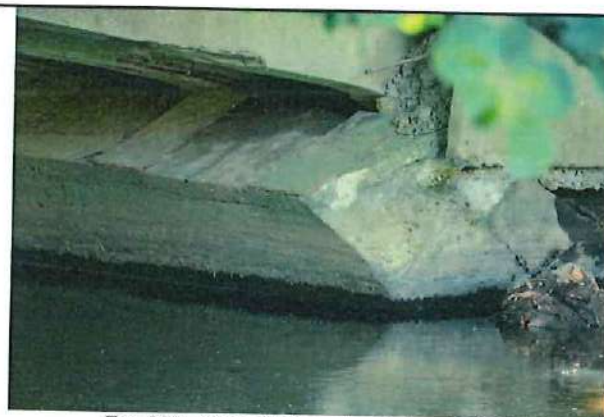
Fot. 324. Przyczółek po stronie drogi DK-6 (Zarwany i uszkodzony przyczółek)
