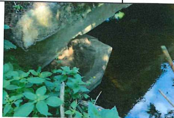
Fot. 320. Lewe skrzydelko przyczółka po stronie drogi DK-6 (Zniszczony przyczółek wraz z lewym skrzydełkiem)
