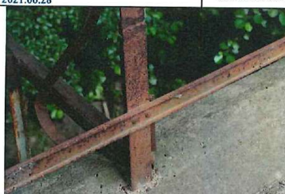
Fot. 144. Balustrada po stronie wody górnej (Powyginane i skorodowane stalowe elementy balustrady, brak powłoki malarskiej, miejscowe wżery, organiczny nalot)
