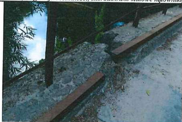
Fot. 289. Kapa i gzyms po stronie wody dolnej (Miejsce załamania konstrukcji, wykruszenia i ubytki betonu, zalegający piasek oraz ziemia, brak powłoki ochronnej)
