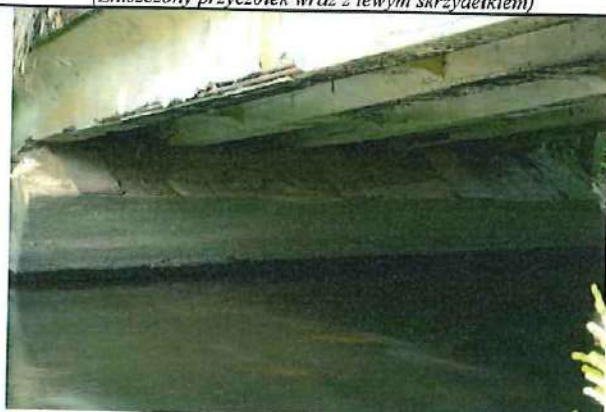
Fot. 321. Przyczółek po stronie drogi DK-6 (Zarwany i uszkodzony przyczółek, obsunięte w koryto rzeki połamane bloki betonu)
