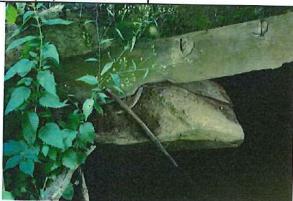
Fot. 319. Lewe skrzydelko przyczółka po stronie drogi DK-6 (Zniszczony przyczółek wraz z lewym skrzydełkiem)
