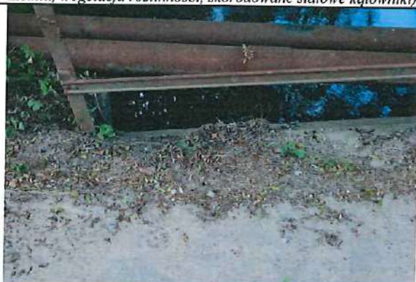
Fot. 259. Kapa i gzyms po stronie wody górnej (Spękania i wykruszenia betonu, zanieczyszczenia, zalegająca ziemia, wegetacja roślinności, skorodowane stalowe kątowniki)
