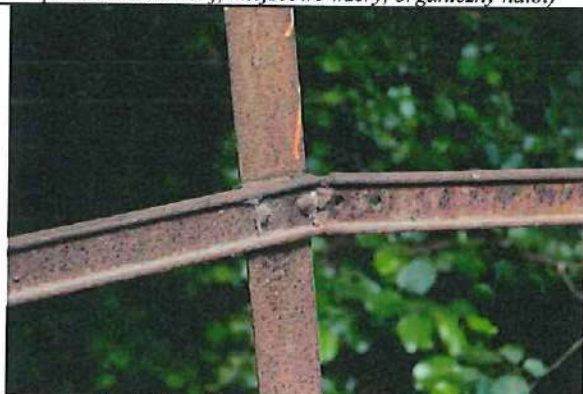
Fot. 147. Balustrada po stronie wody górnej (Powyginane i skorodowane stalowe elementy balustrady, brak powłoki malarskiej, miejscowe wżery, organiczny nalot)
