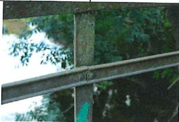
Fot. 191. Balustrada po stronie wody dolnej (Powyginane i skorodowane stalowe elementy balustrady, brak powłoki malarskiej, miejscowe wżery, organiczny nalot)
