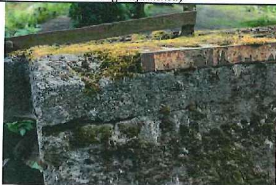
Fot. 211. Balustrada po stronie wody dolnej (Poniszczony mur oporowy, spękania, wykruszenia betonu, organiczny nalot, skorodowane stalowe elementy balustrady, wegetacja mchów)
