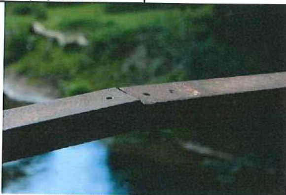
Fot. 175. Balustrada po stronie wody dolnej (Powyginane i skorodowane stalowe elementy balustrady, brak powłoki malarskiej, miejscowe wżery, organiczny nalot)
