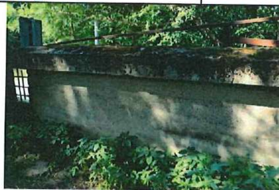
Fot. 240. Balustrada po stronie wody dolnej (Skruszony beton murka, spękania betonu, organiczny nalot, brak powłoki ochronnej betonu, korozja odsłoniętego zbrojenia oraz stalowych elementów balustrady, wegetacja mchów)
