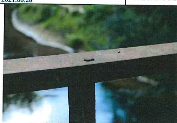
Fot. 176. Balustrada po stronie wody dolnej (Powyginane i skorodowane stalowe elementy balustrady, brak powłoki malarskiej, miejscowe wżery, organiczny nalot)
