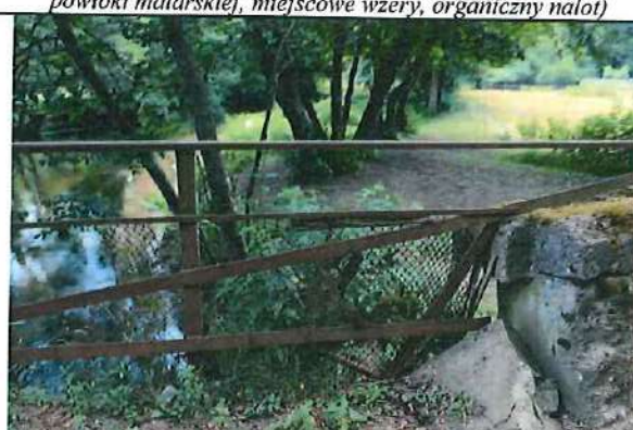
Fot. 166. Balustrada po stronie wody dolnej (Powyginane i skorodowane stalowe elementy balustrady, brak powłoki malarskiej, miejscowe wżery, organiczny nalot)
