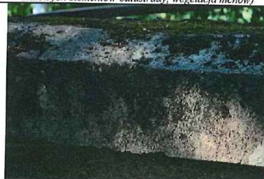
Fot. 246. Balustrada po stronie wody dolnej (Skruszony beton murka, spękania betonu, organiczny nalot, brak powłoki ochronnej betonu, korozja odsłoniętego zbrojenia oraz stalowych elementów balustrady, wegetacja mchów)
