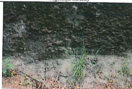
Fot. 214. Balustrada po stronie wody dolnej (Poniszczony mur oporowy, spękania, wykruszenia betonu, organiczny nalot, balustrady, wegetacja mchów)
