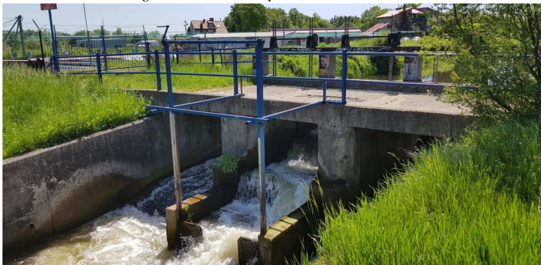
Fotografia nr 12. Jaz - urządzenie wodne na rzece Reda
